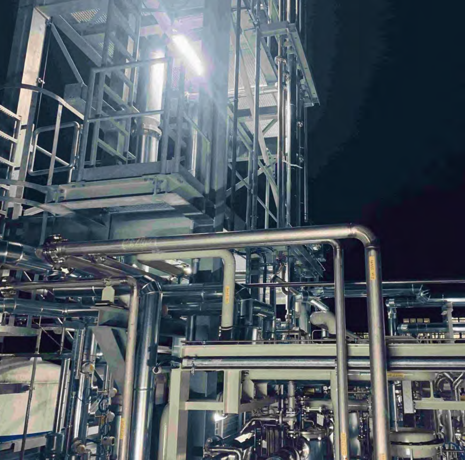
Dach und Turm der Synthesegasreinigungsanlage
