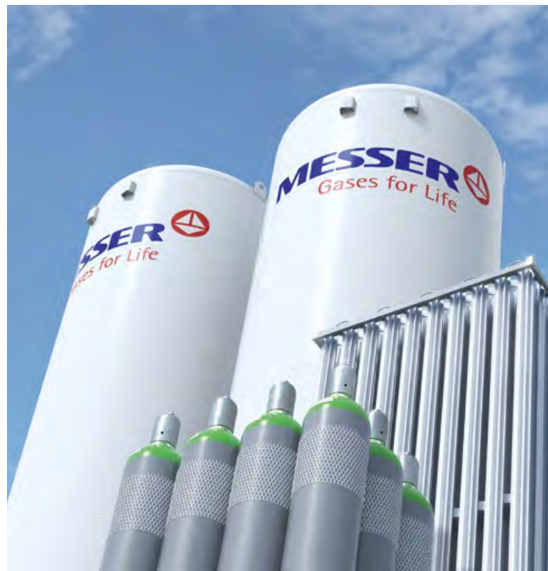
Tanks mit Verdampfern für die Sauerstoffversorgung
